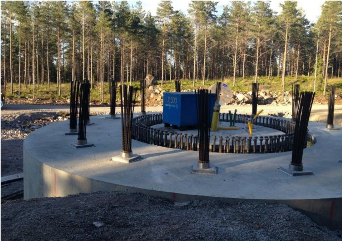
Figur 10 Bergförankrat fundament i SR Energys vindpark Lemnhult. Källa: SR Energy.
