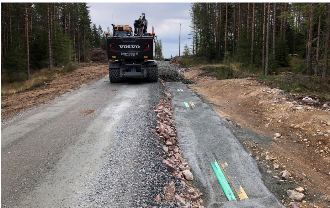
Figur 15. Kabelgrav med kabel och kommunikationsnät intill väg.
