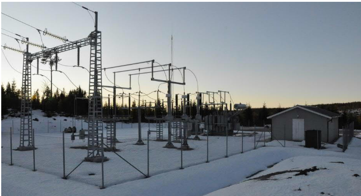
Figur 22. Foto över utomhusställverk vid Upprämnen i Dalarna som ägs av Ellevio.
